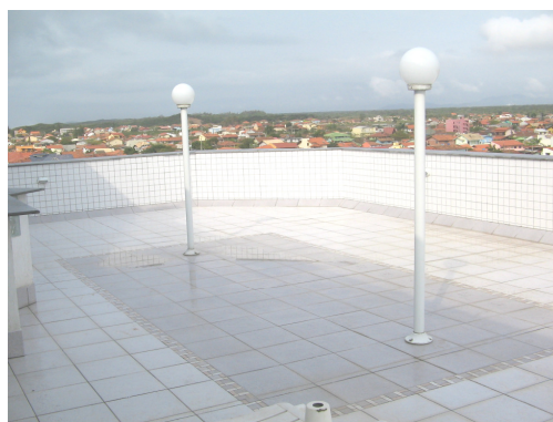
Terraço de edifício, variação dimensional do revestimento cerâmico do piso possibilita cisalhamento da impermeabilização
